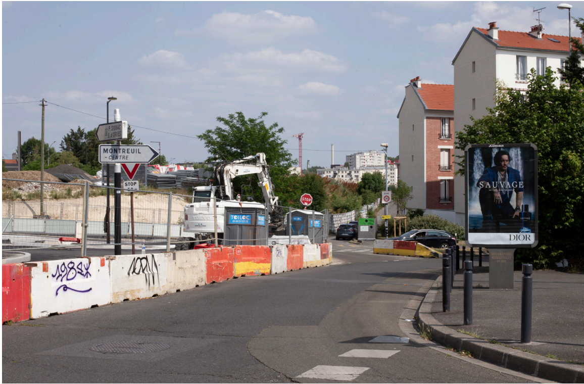
Tram, lisière et Johnny Depp - Rue de Romainville. Montreuil, 9 juin 2025. Chantier du T1.
